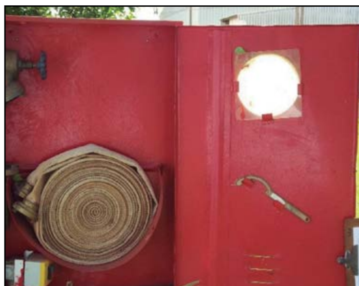
Figura 6. Acondicionamento correto das mangueiras e demais equipamentos do hidrante.
