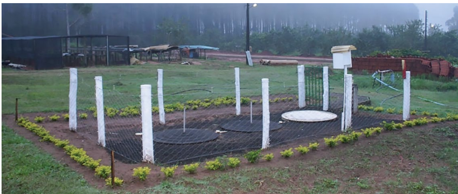
Figura 11. Imagem de fossa séptica biodigestora instalada
