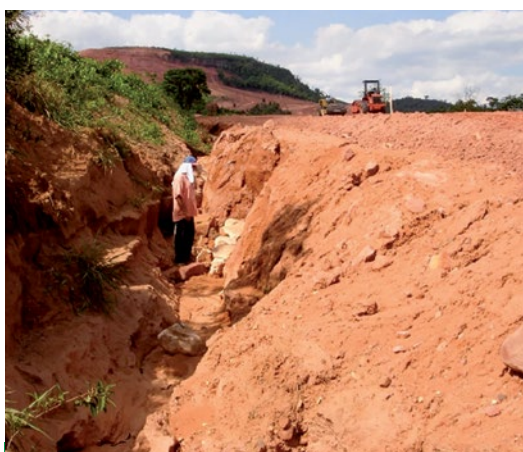
Figura 4. Erosão em ravina
