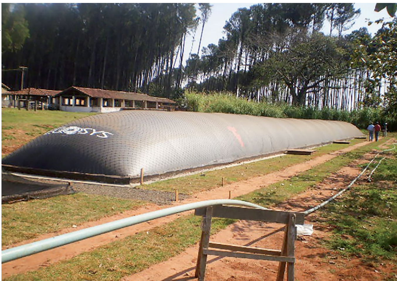
Figura 4. Imagem de um biodigestor anaeróbio do tipo “lagoa coberta”
